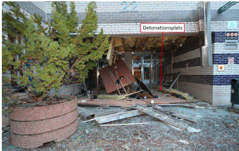
Skador efter en sprängning i mitten av januari 2023, vid en adress kopplad till ”Greken”.
