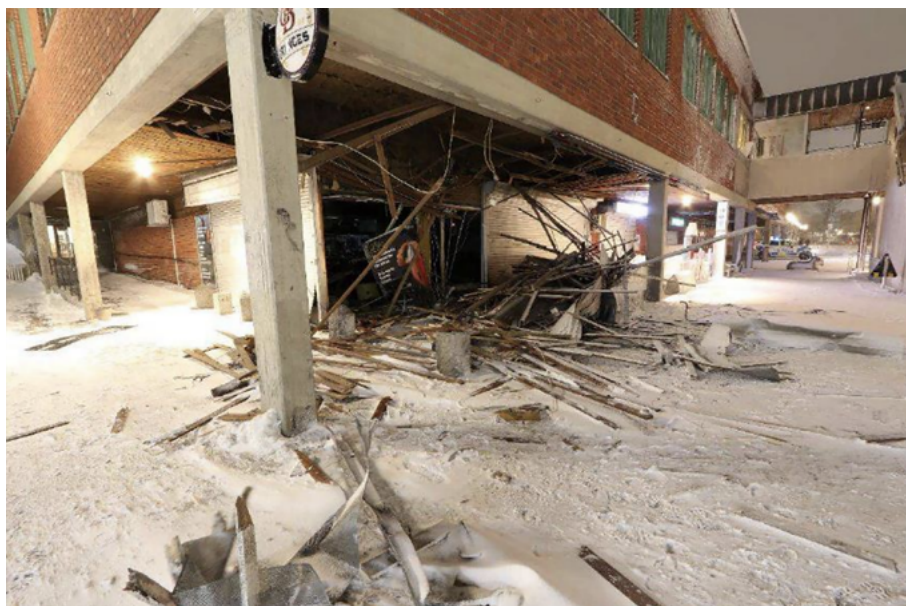
Stora skador på en restaurang i Bredäng, efter ett sprängdåd den 11 januari 2025.
